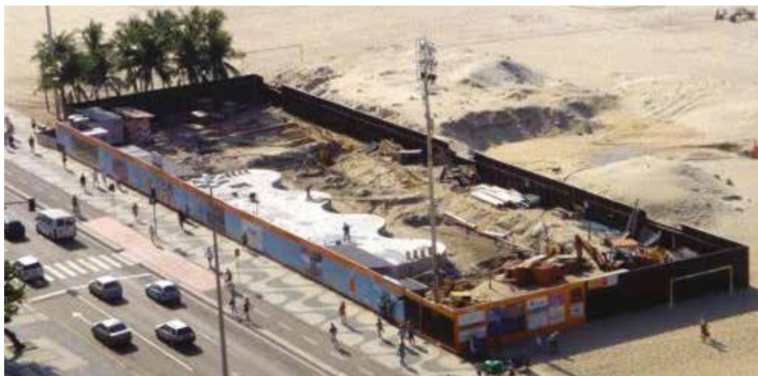
Figura 42 - Faixa de areia interdita para obras de construção do subsolo dos quiosques. Fonte: Orla Rio.
