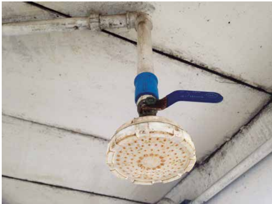
Figura 21 - Tubulação exposta, ferrugem na válvula de acionamento e marcas de sujeira e deterioração no chuveiro. Fonte: elaboração própria.
