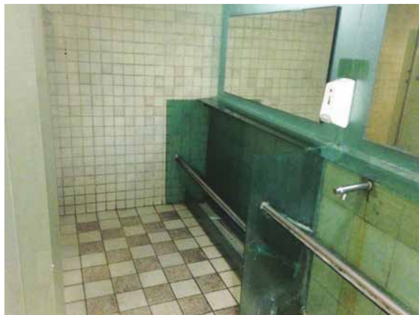
Figura 17 - Manchas de infiltração, ferrugem e falta de manutenção dos sanitários da Orla Rio. Fonte: elaboração própria.
