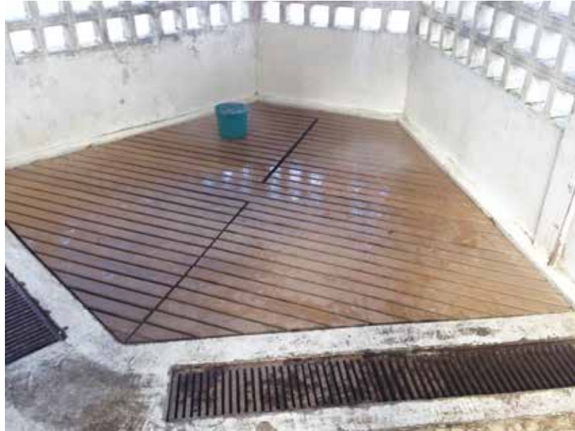
Figura 22 - Deck localizado logo abaixo dos chuveiros. Balde coletando água proveniente da goteira de um dos tubos do sistema hidráulico do posto. Fonte: elaboração própria.
