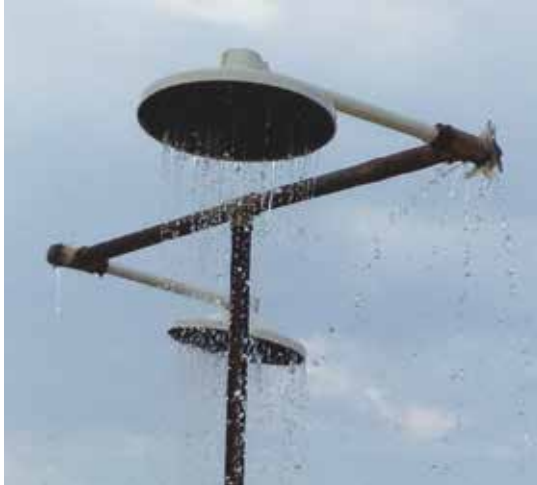
Figura 5 - Vazamentos. Fonte: elaboração própria.
