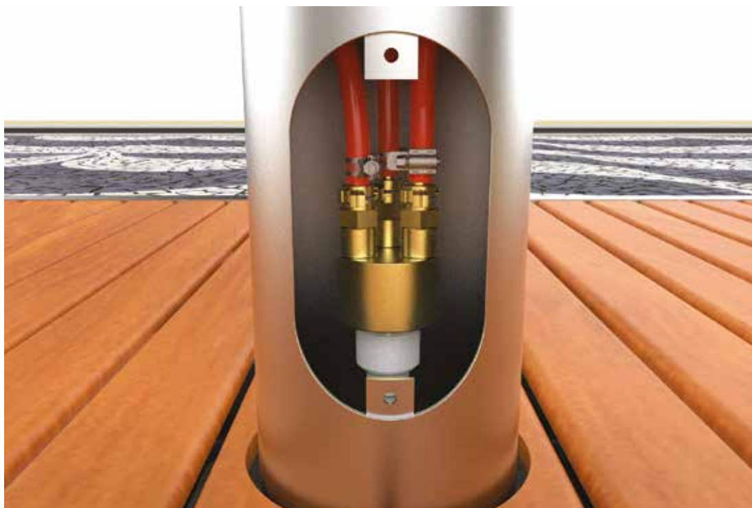
Figura 115 -Conexão entre as mangueiras e o Divisor de Água. Fonte: Elaboração própria.
