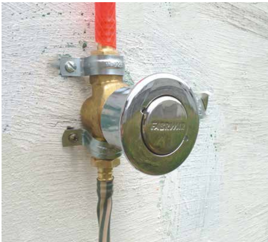
Figura 151 - Fixação da válvula na parede com auxílio de abraçadeiras. Fonte: Elaboração própria.
