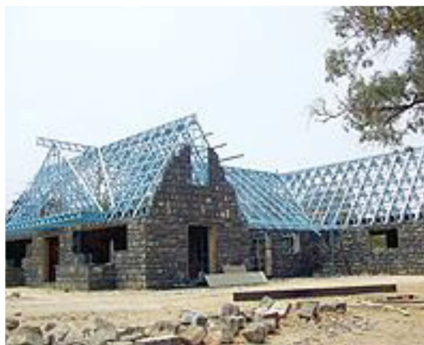
Figura 21: Estrutura de Cobertura em LSF para Edificação Convencional. Fonte: Revista Técnica edição 147
