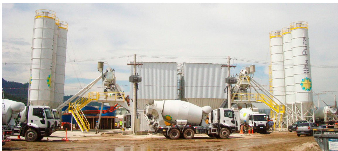
Figura 29 – Central de concreto Vila dos Atletas (Fonte: SCHWING-STETTER, 2013)
