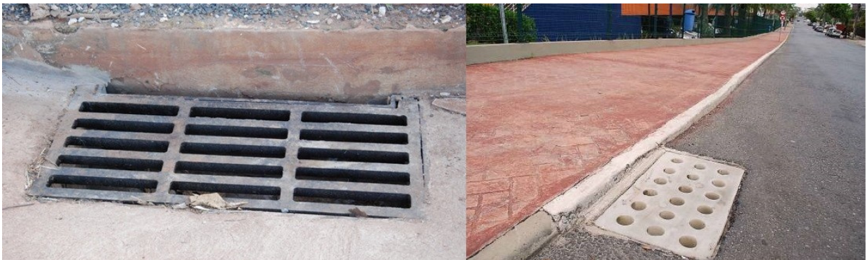
Figura 20 – Grelhas de Ferro fundido e de concreto (Fonte: http://www.ocoerreionews.com.br/noticia/11331-secretaria-de-obras-substitui-bueiros-em-costa-rica.html )
