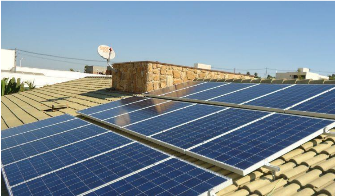
Figura 107: Placas fotovoltaicas instaladas sobre telhado de cerâmica. Fonte: https://www.destakjornal.com.br/seu-valor/franquias/detalhe/blue-sol-energia-solar-franquia-busca-novos-franqueados-em-cidades-com-mais-de-600-mil-pessoas (Acessada em 24/11/2018).
