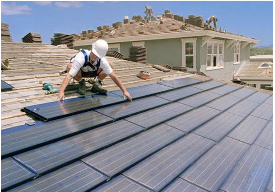
Figura 108: Instalação de telha solar sobre ripas de madeira. Fonte: https://www.computerworld.com/article/3128255/sustainable-it/rooftop-solar-installation-prices-drop-as-does-payback-time.html (Acessada em 24/11/2018).
