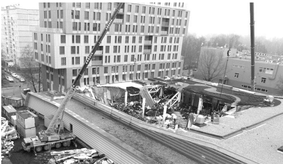
Figura 11: Desabamento no Shopping Center Zolitude com telhado verde em 2013, em Riga, Letônia.
