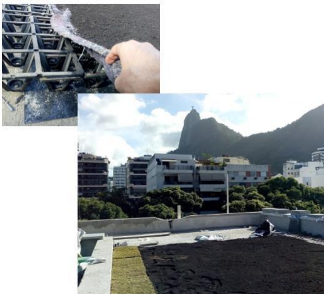
Figura 16: Assentamento do substrato terra para acomodação dos tapetes de grama em telhado verde no edifício Firjan RJ, em Botafogo, Rio de Janeiro. Elaboração própria.
