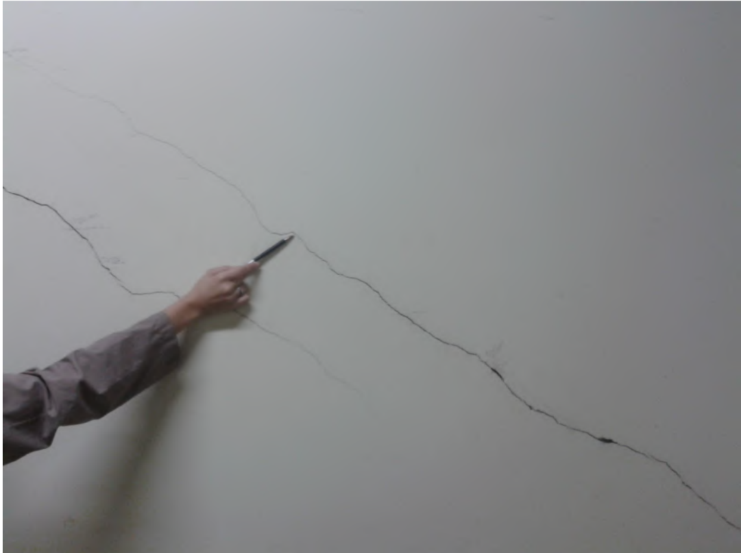
Figura 7.6: Trincas existentes entre o pilar P335 e o bloco adjacente
