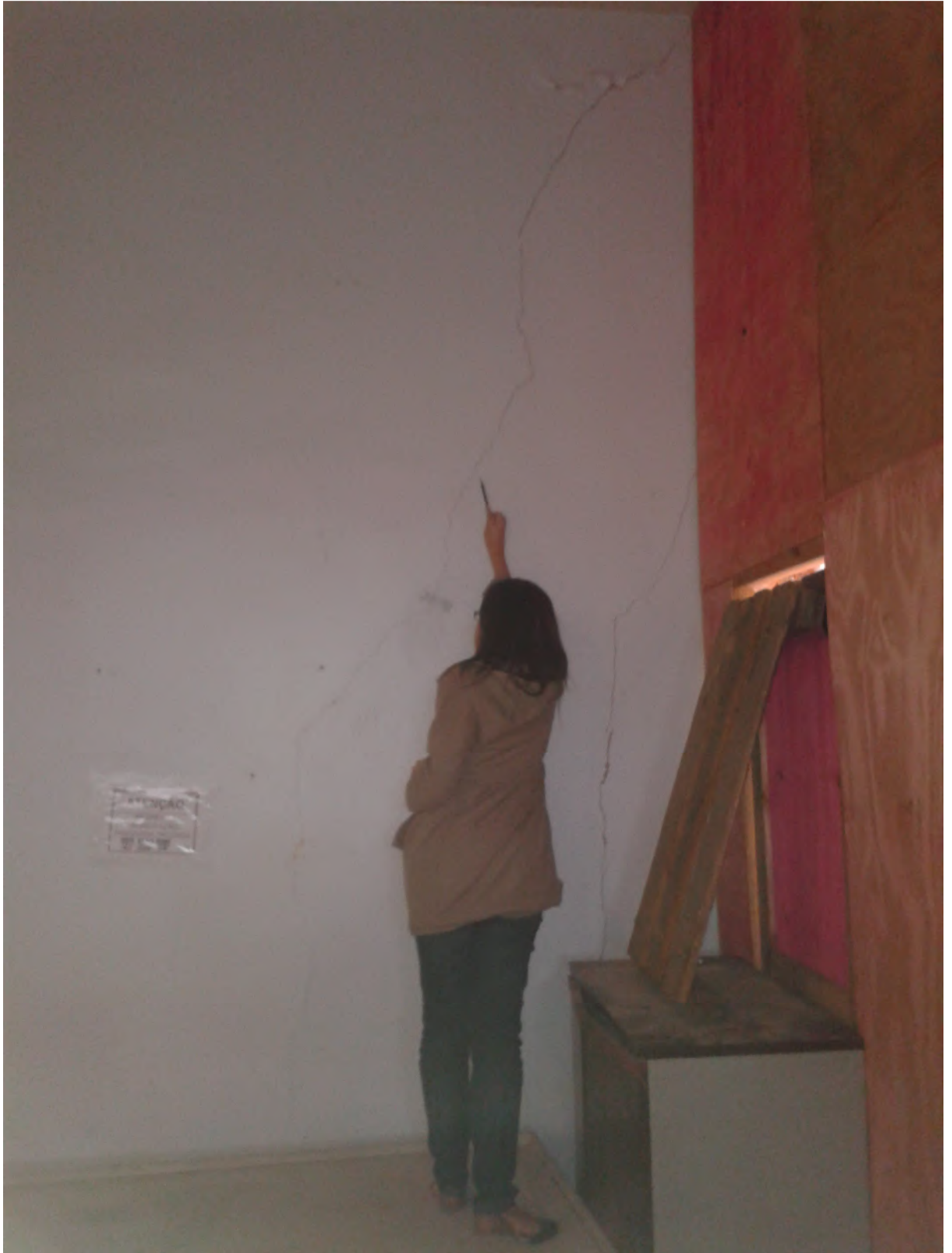
Foto 7.11: Trincas existentes na parede entre o P323 e P324
