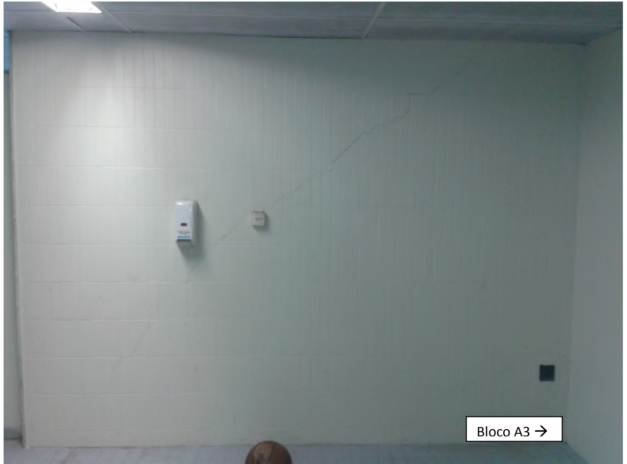
Figura 7.12: Foto das trincas existentes no prédio adjacente
