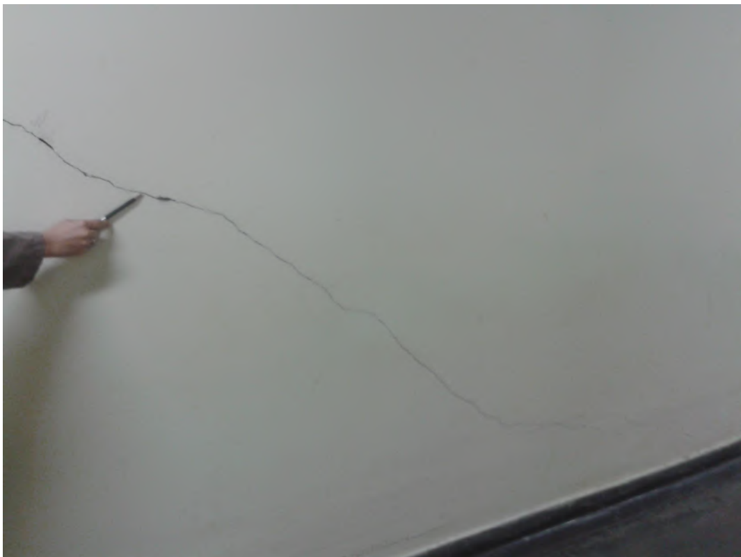
Figura 7.7: Trincas existentes entre o pilar P335 e o bloco adjacente
