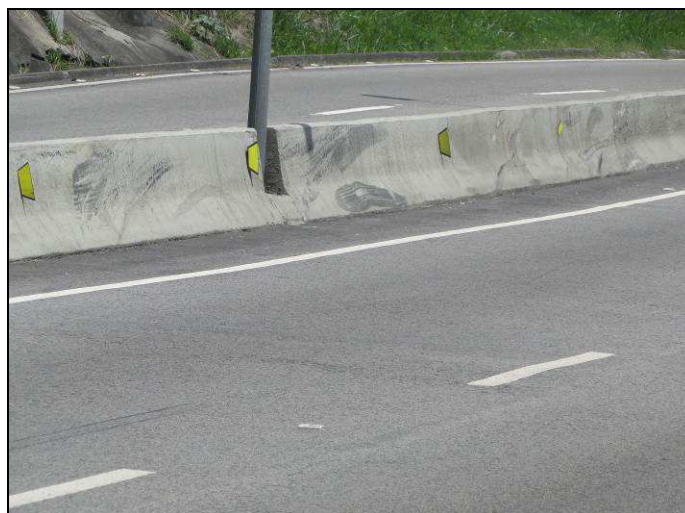
Figura 4.21: Marcas nas barreiras de concreto centrais (Ponto 1).
