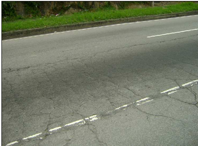
Figura 4.28: Defeitos no pavimento (Ponto1).
