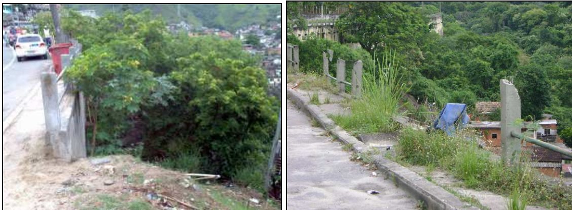
Figura 4.26: Proteção inadequada e inexistente (Ponto 2).
