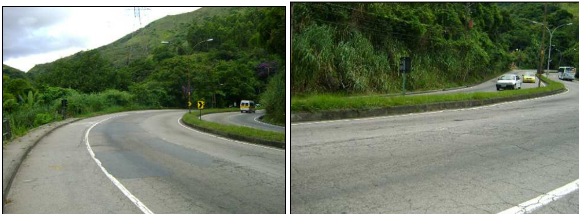
Figura 4.31: Falta de Superelevação.
