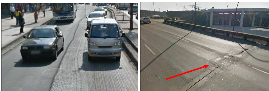
Figura 3.5: Locais com Desníveis e Deformações no pavimento Fonte: Google Maps
