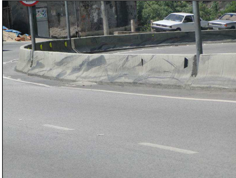
Figura 4.25: Marcas nas Barreiras de Concreto Centrais.
