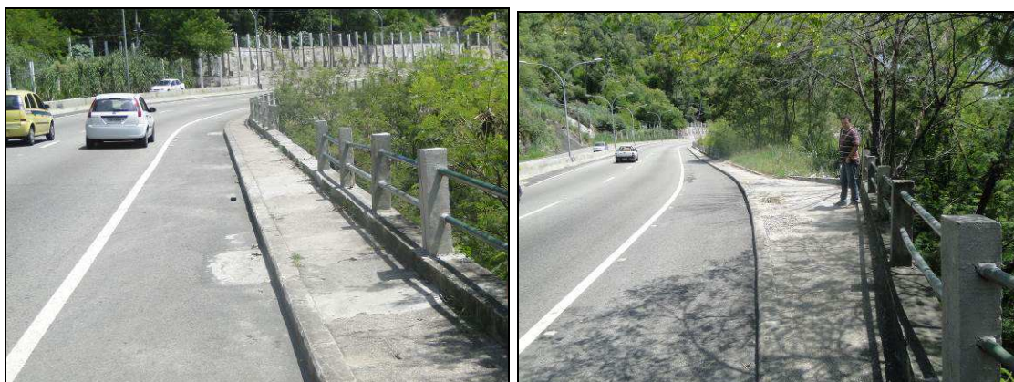
Figura 4.22: Proteção inadequada e inexistente (Ponto 1).
