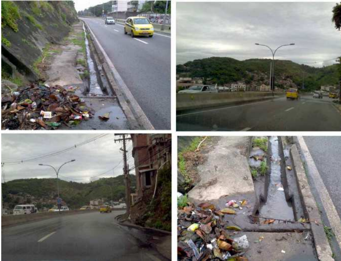
Figura 4.46: Problemas quanto a Drenagem no Ponto 12.
