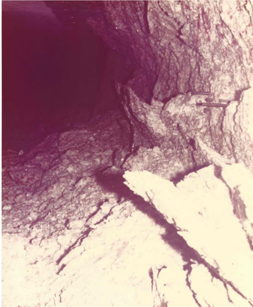
Figura 105. Processo de desagregação das paredes e pilares da mina de potássio Mississipe Chemical , por excesso de deformação por fluência
