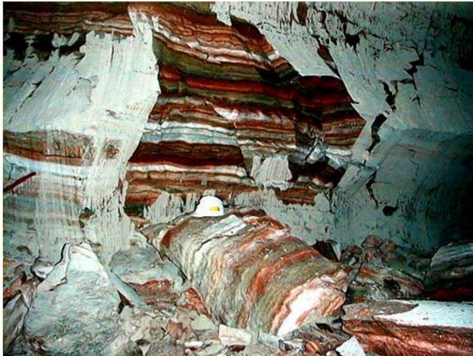
Figura 94. Desabamentos de cantos dos pilares de painéis de uma mina de potássio. Fenômeno usual em minas convencionais de sal
