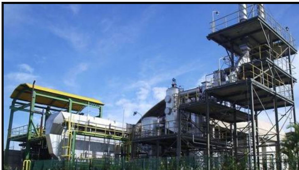
Figura 7 - Usina piloto de tratamento térmico com geração de energia elétrica no Rio de Janeiro
