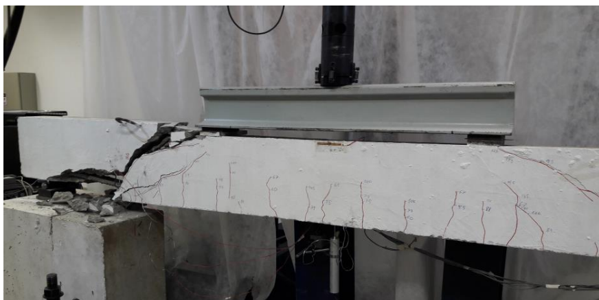
Figura 4.3: Ruptura viga E3-1.
