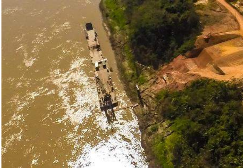
Figura 14. Talude na margem direita do rio Madeira, a montante de Porto Velho-RO.
