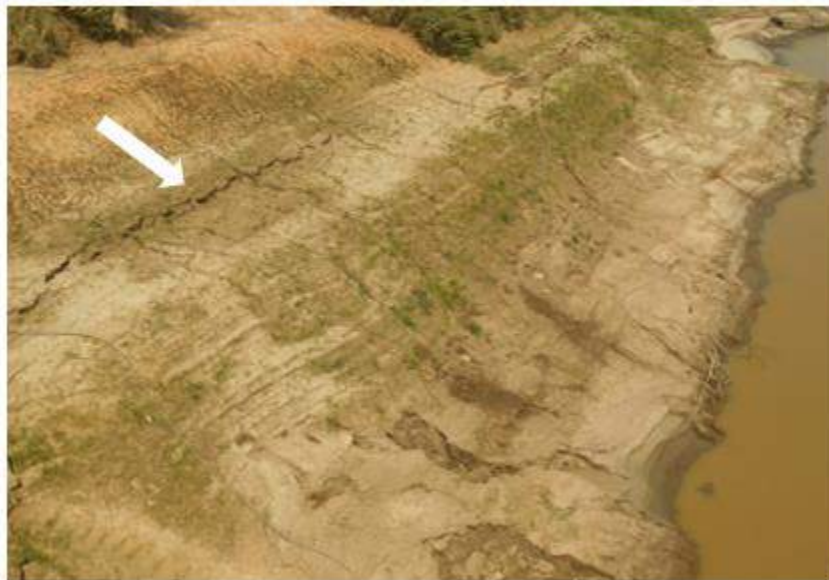
Figura 15. Trincas no talude na margem direita do rio Madeira.
