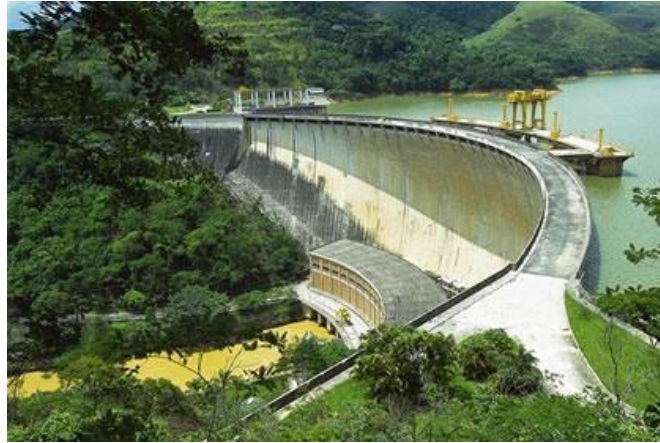
Figura 6: Usina Hidrelétrica de Funil. Fonte: Furnas
