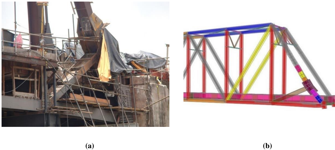
Figura I-2 – (a) Estrutura com intervenção estrutural; (b) modelagem computacional da estrutura com reforço (SOUZA, 2012)
