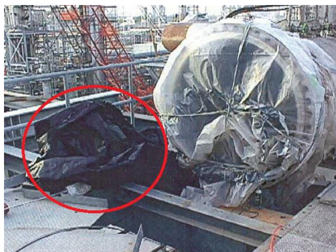
Figura 4.6 - Abertura da tubulação isolada por plástico transparente. Destacado em vermelho o plástico preto utilizado pelos trabalhadores. Adaptação (U.S. CSB, 1999).
