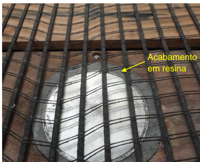
Figura 3.17. Célula de pressão total (CPT) instalada sobre o bordo de um dos capitéis, detalhe para o acabamento em resina.
