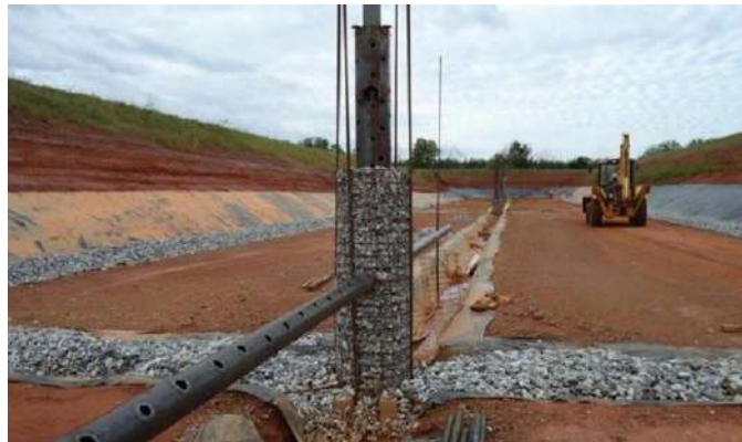
Figura 26: Sistema de captação de líquidos e gases do aterro sanitário. Fonte: Internet (2019).
