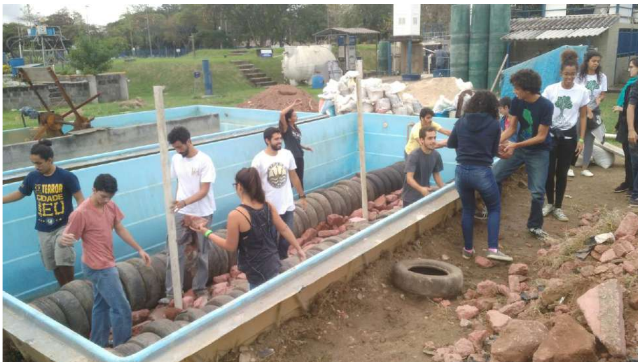
Figura 35: Curso de introdução ao saneamento ecológico com implementação de uma bacia de evapotranspiração (BET) para tratamento de esgotos domésticos no Centro Experimental de Saneamento Ambiental (CESA) da UFRJ. Fonte: MUDA (2017).
