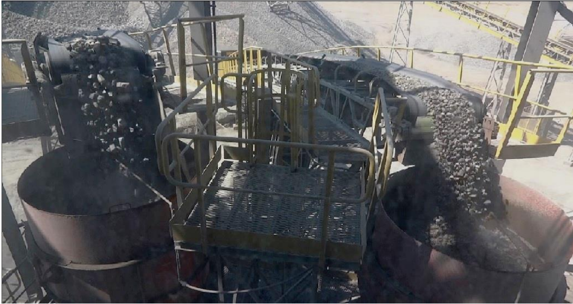
Figura 3.5 – Britadores terciário e quaternário em operação
