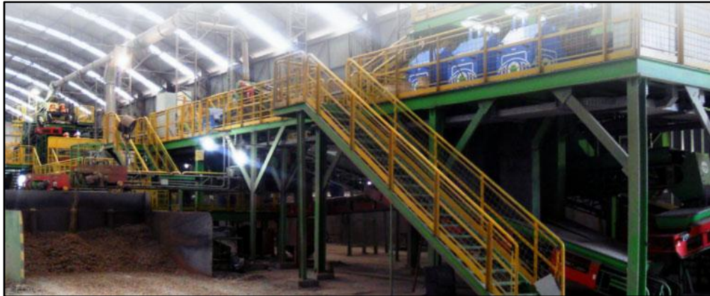
Figura 25 - Usina automatizada de beneficiamento de caco na Vidroporto
