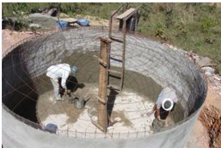
Figura 36: exemplo de reservatório de ferro-cimento
