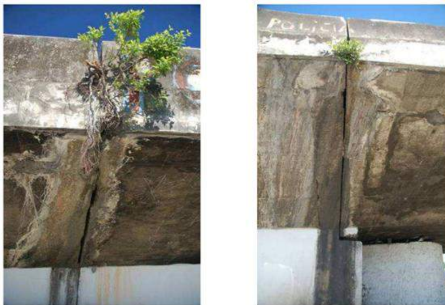
Figura 2 4: Juntas do viaduto do Forte das Cinco Pontas - Recife. Fonte: PINHO (2011).
