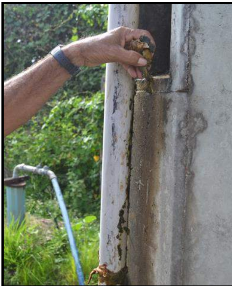
Figura 53 - Foto do lodo formado no tubo por onde passa a água captada em decorrência da presença de sais e da escola
