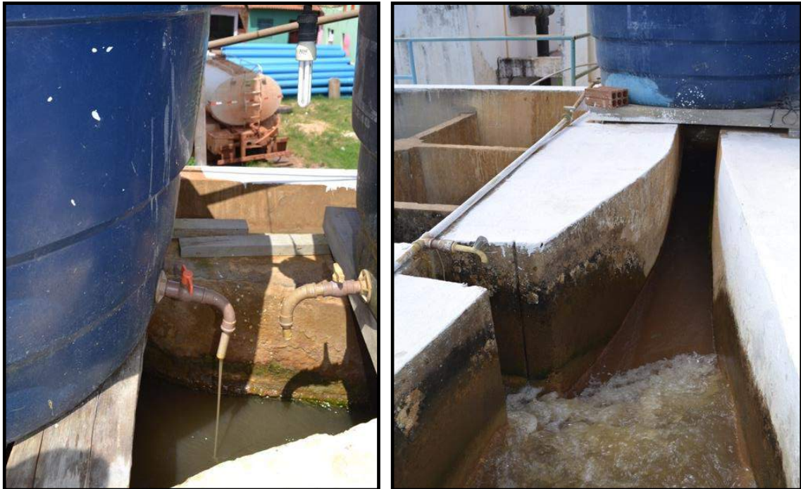
Figura 30 - Fotos da aplicação de coagulante sulfato de alumínio na água e sua passagem pela calha Parshall Fonte: Autoria própria
