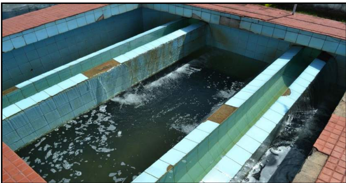
Figura 33 - Foto da etapa de filtração, com filtro descendente Fonte: Autoria própria
