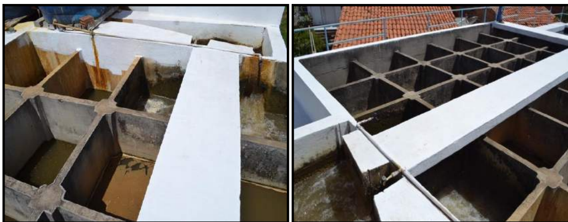
Figura 31 - Fotos do tanque de floculação Fonte: Autoria própria
