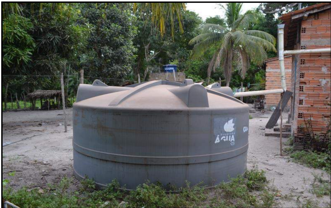
Figura 10 – Reservatório apoiado da CODEVASF de 16 mil litros instalado pelo Programa 1 Milhão de Cisternas em Arari - MA
