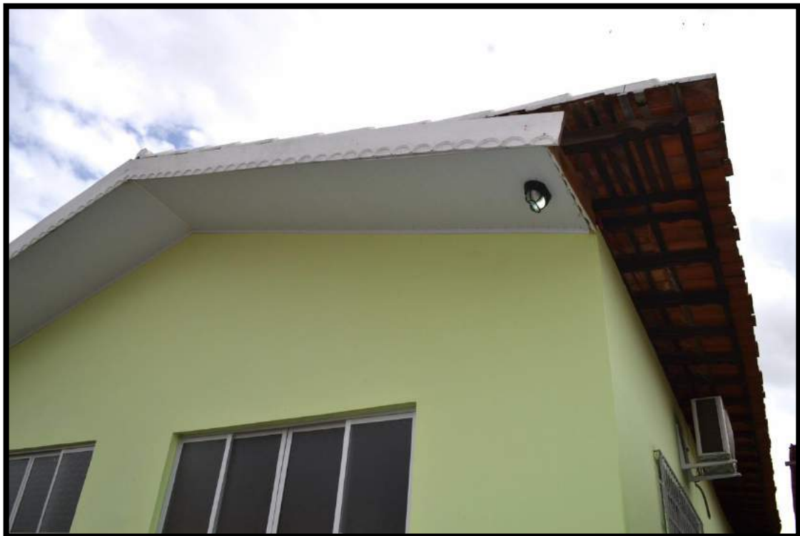
Figura 43 - Foto do telhado de telhas de barro da E.M. Professora Luiza Francelina Fonte: Autoria própria
