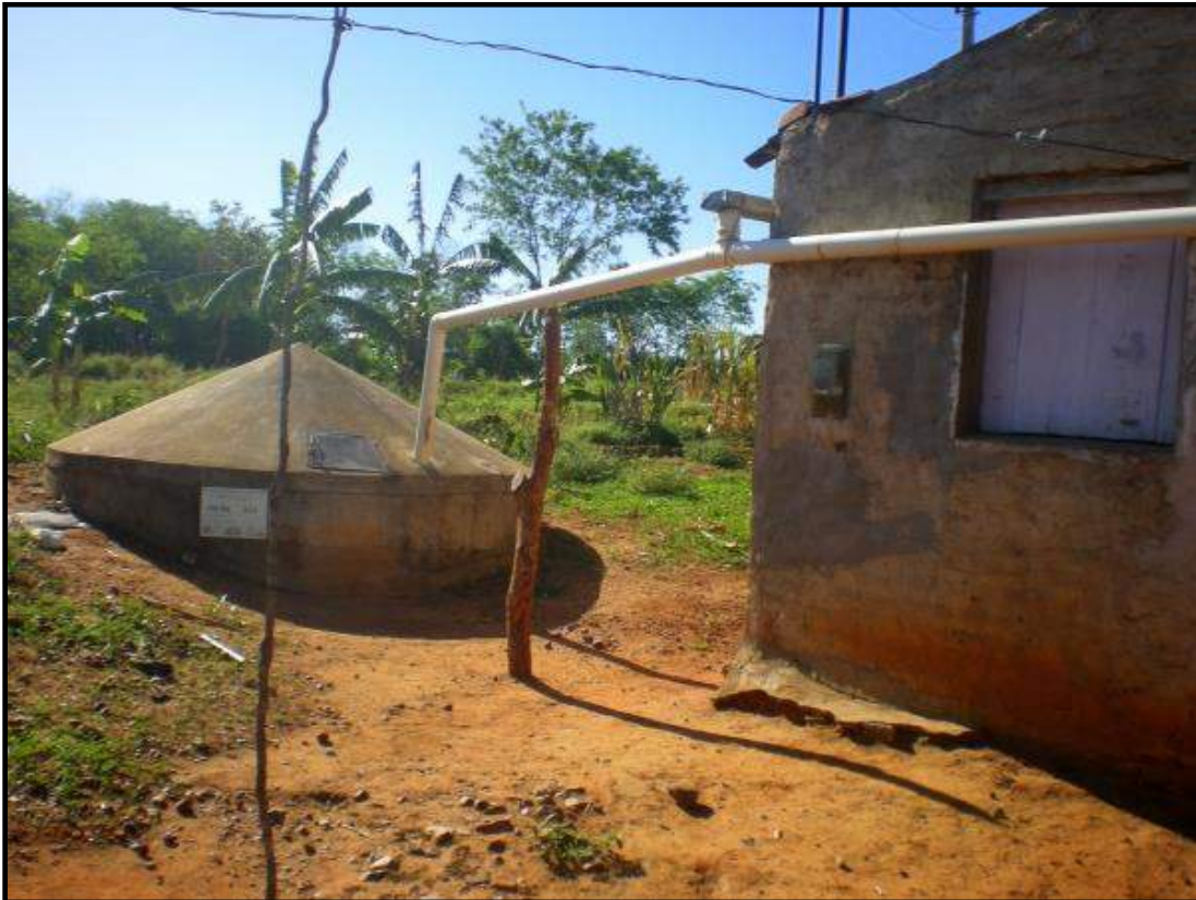
Figura 8 – Foto de suporte colocado de forma improvisada para apoiar a tubulação Fonte: Celso Calheiros
