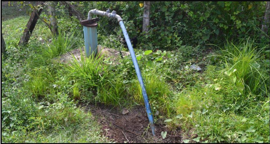
Figura 51 - Foto do poço de onde é retirada a água para consumo não potável da comunidade e da escola Fonte: Autoria própria
