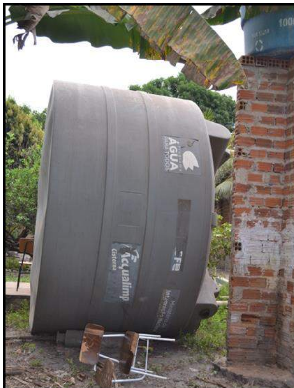
Figura 65 - Foto da caixa d'água de 16 mil litros instalada pelo P1MC que se encontra em desuso devido a defeito na bomba Fonte: Autoria própria
