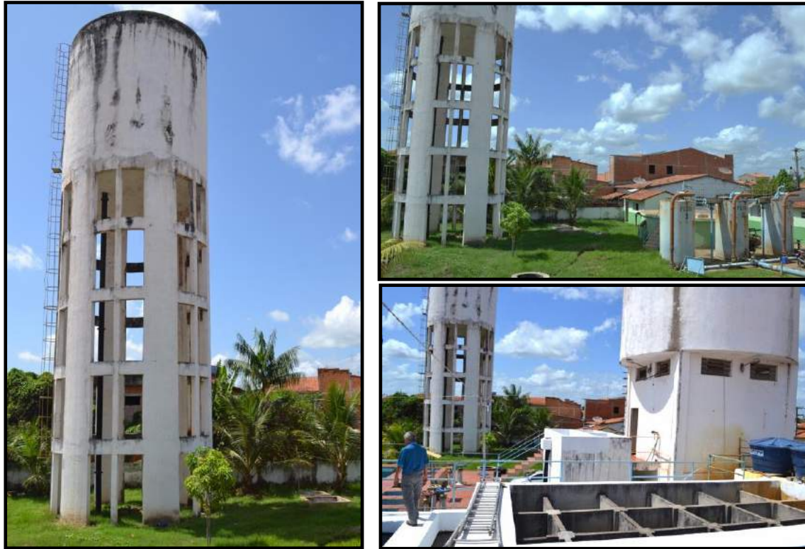
Figura 34 - Fotos do reservatório elevado do município e da ETA, com um dos operadores da estação
