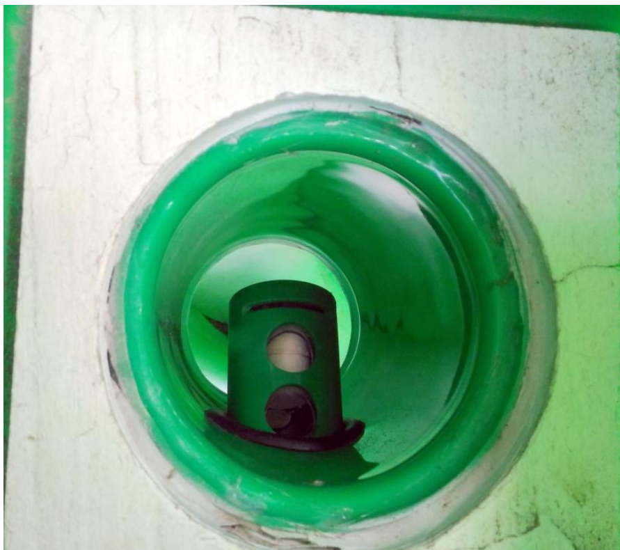
Figura 23 – Placa de calcário (localizada abaixo do cilindro) e dosador de cloro ao fundo.
