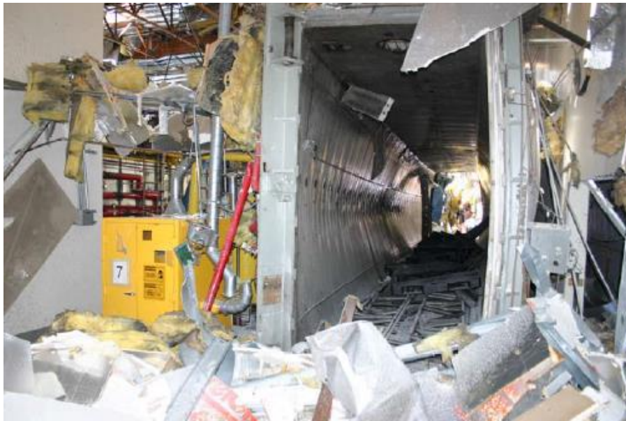
Figura 18 - Danos na sétima câmara de esterilização pós explosão
