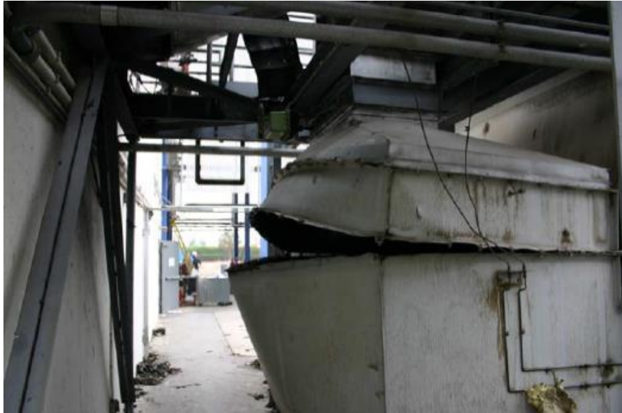
Figura 17 - Danos no queimador pós explosão
