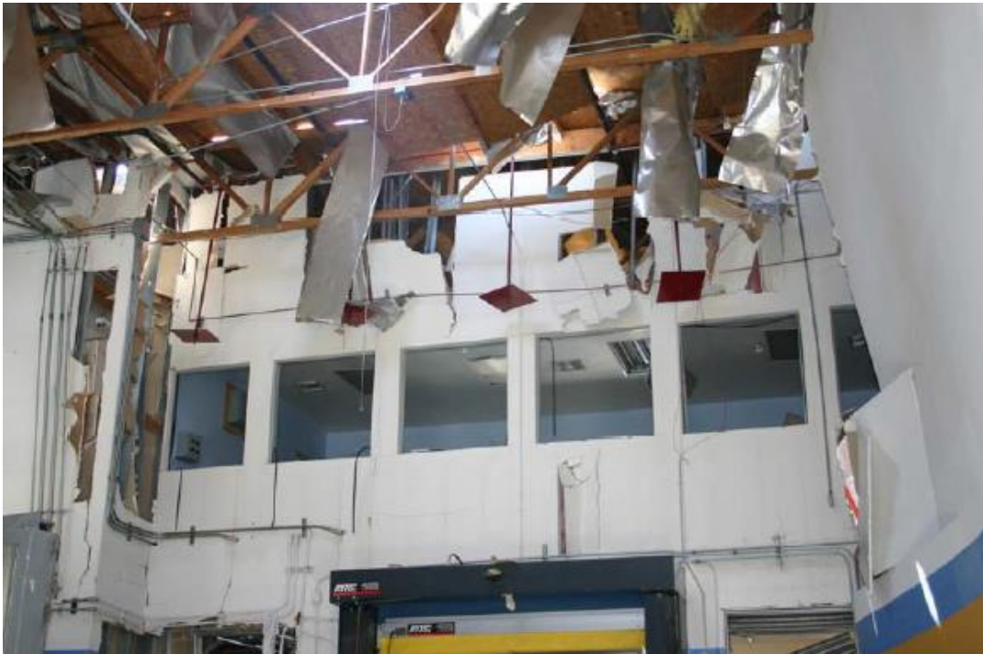
Figura 16 - Janelas de vidro da sala de controle quebradas com o impacto
