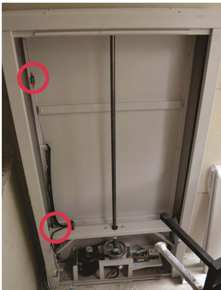
Figura 62 – Alturas definidas dos micro interruptores de ação rápida na obra (Fonte: elaboração própria).
