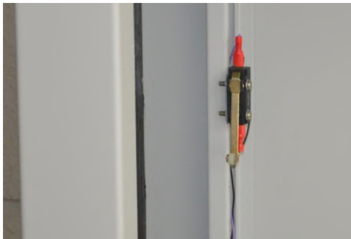
Figura 61 – Micro interruptor de ação rápida instalado (Fonte: elaboração própria).
