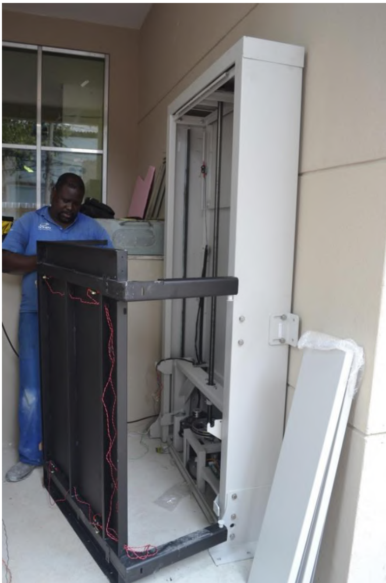
Figura 37 – Montagem do elevador da plataforma de acessibilidade na obra (Fonte: elaboração própria).
