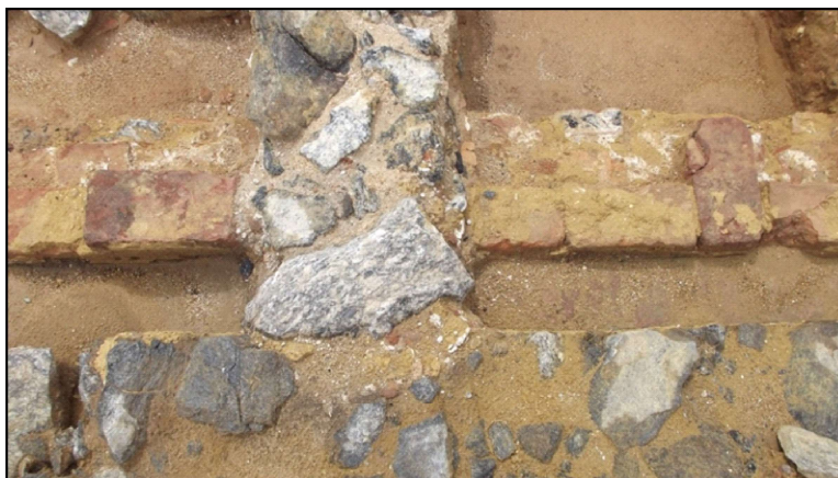
Figura 35. Canaleta obstruída pela passagem de um alicerce, em construção posterior, inutili- zando sua função. Foto das autoras.
