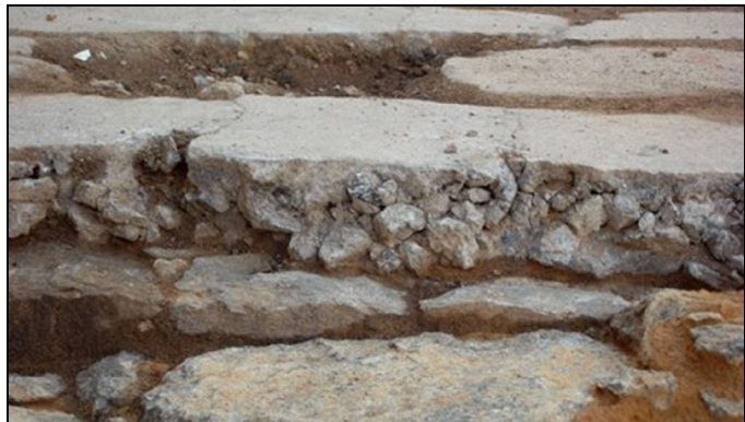
Figura 30. O cuidadoso preparo da elevação do piso de lajotas do pátio dos fundos. Fotos das autoras.
