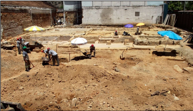
Figuras 14 e 15. Exposição dos alicerces das antigas edificações em 1/3 do terreno, concomitante à escavação mecânica nos demais trechos. Fotos das autoras.
