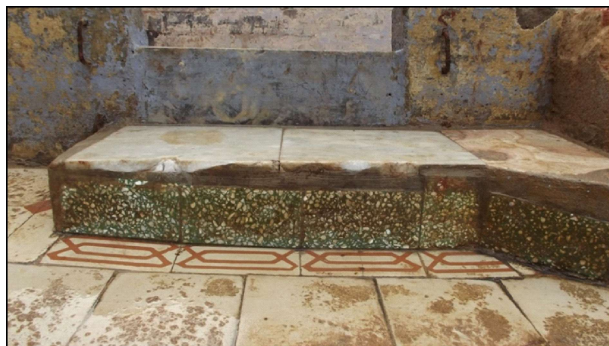
Figura 50. Ladrilhos hidráulicos misturados a piso de aglomerado com conchas nacaradas em preto e branco. Foto das autoras.
