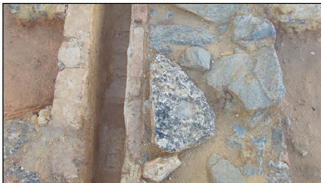
Figura 33. Detalhe do sistema construtivo da canaleta de seção em U, com paredes e fundo em tijolos maciços.
