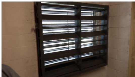
Figura 7.1 - Abertura para o ar de renovação.
