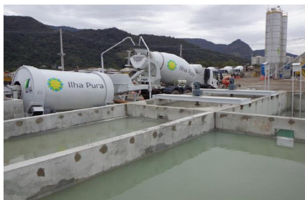
Figura 38: Recicladora de Concreto (fonte: Arquivos Ilha Pura, 2014)
