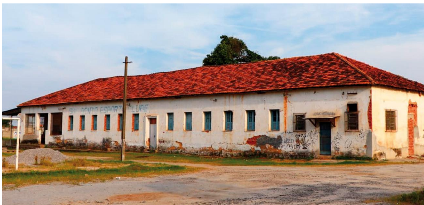
Fachada frontal da antiga Casa de Farinha. Percebe-se a degradação do patrimônio pelas manchas, descascamento e alterações de vãos. (Fonte MVSB).
