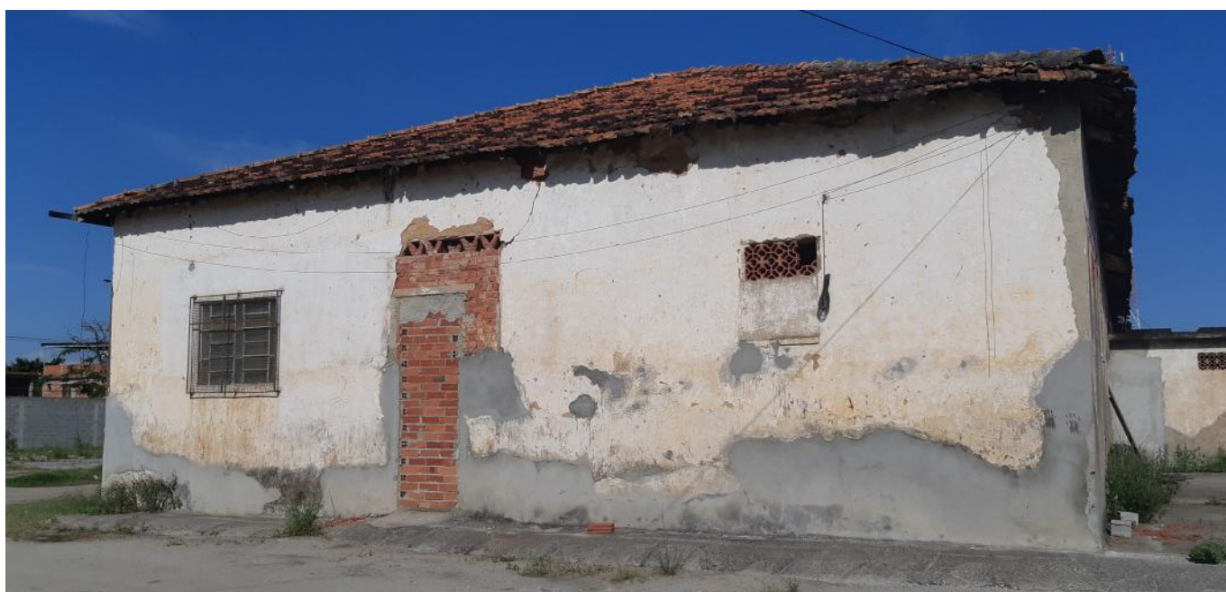
Fachada lateral direita da antiga Casa de Farinha. Não se tem registro da fachada original, mas novas aberturas foram feitas pela CEDAE. É possível perceber uma tentativa de revestimento posterior e muita sujeira. (Fonte autoral).
