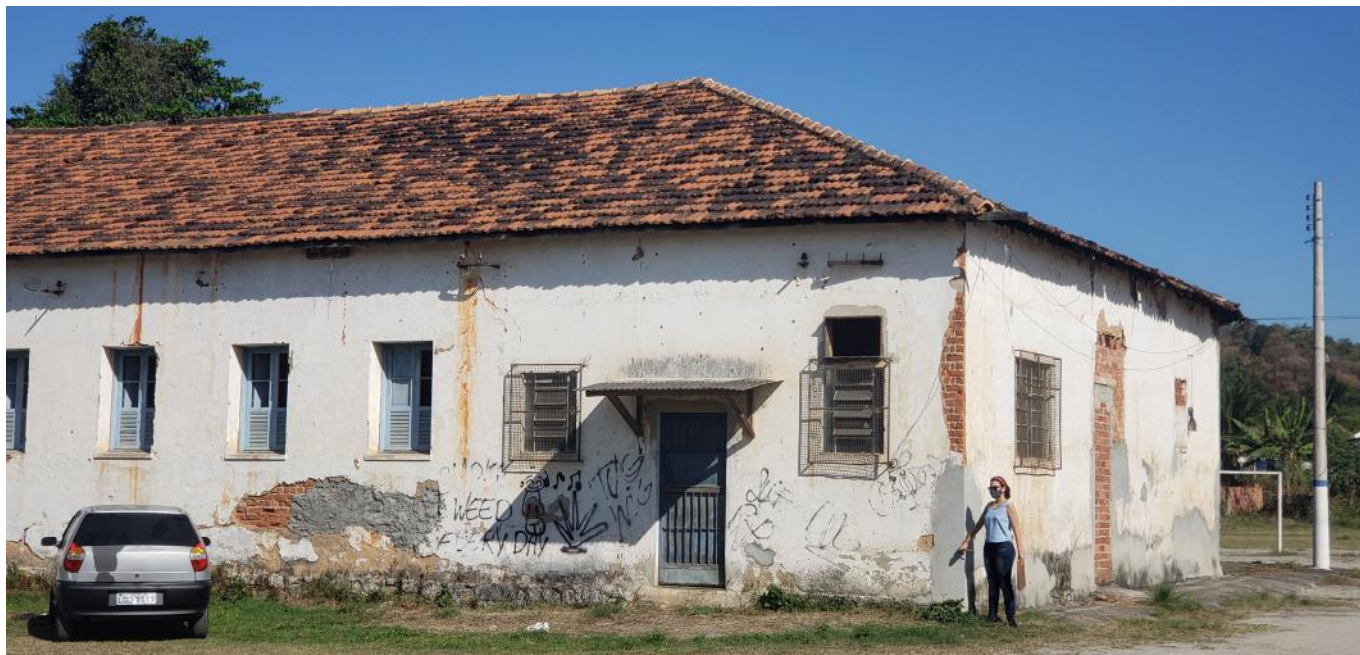
Aproximação parte direita da fachada frontal da antiga Casa de Farinha. Foi modificada pela CEDAE com abertura de novas esquadrias. É possível ver melhor os tijolos maciços originais expostos. (Fonte autoral)
