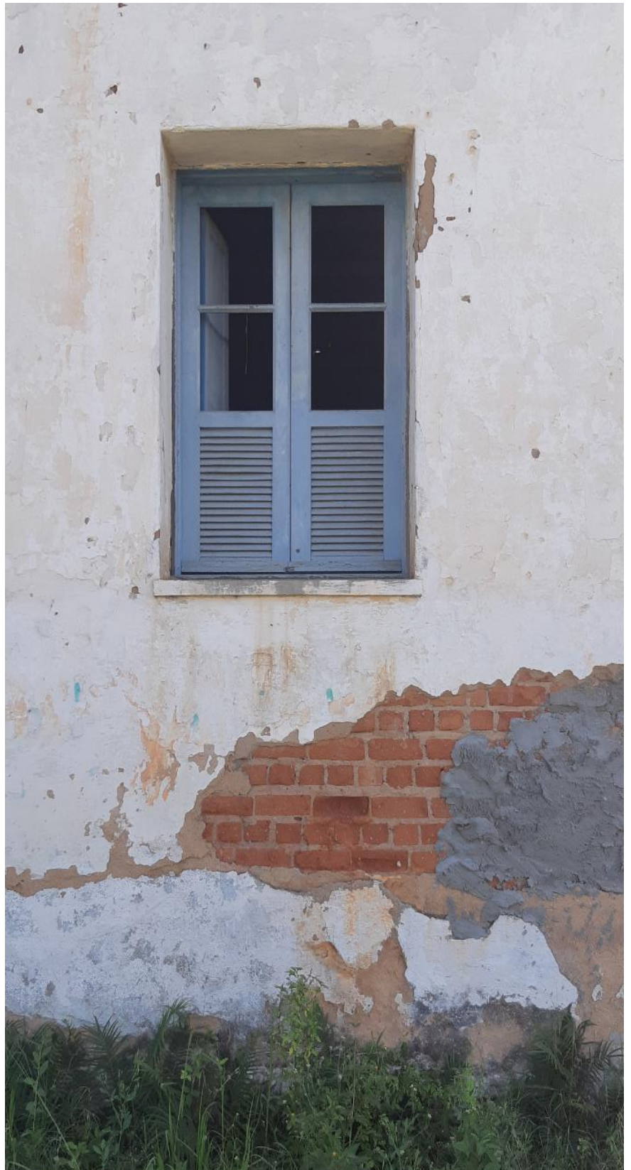
Aproximação da fachada frontal. É possível ver a estrutura de vedação usada, o tijolo maciço, e sua forma de assentamento: o inglês (english brick bonding). (Fonte autoral)
