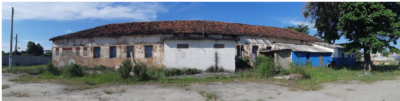
Fachada posterior da antiga Casa de Farinha. Grande parte das esquadrias foram subtraídas para a construção dos anexos de vestiários. Além disso, muitas manchas negras e de umidade, existência de vegetação e fungos. (Fonte autoral)
