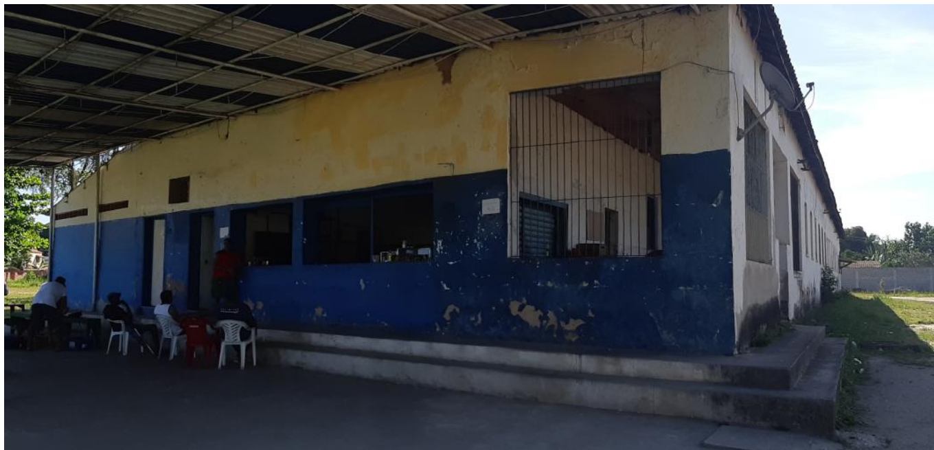
Fachada lateral esquerda da antiga Casa de Farinha. Novas aberturas para a cozinha e criação de dois banheiros. Grande mancha de umidade perto da cobertura e descascamento da pintura. (Fonte autoral)
