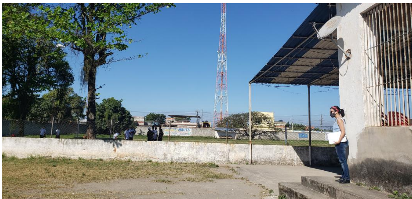
Encontro entre a fachada frontal e a lateral esquerda. Atenção para a cobertura não original, instalações elétricas inadequadas, revestimentos posteriores e grandes degraus de acesso. A teoria por parte do diretor do clube é que o terreno cedeu, expondo o primeiro degrau e a fundação em pedra da casa. (Fonte autoral)
