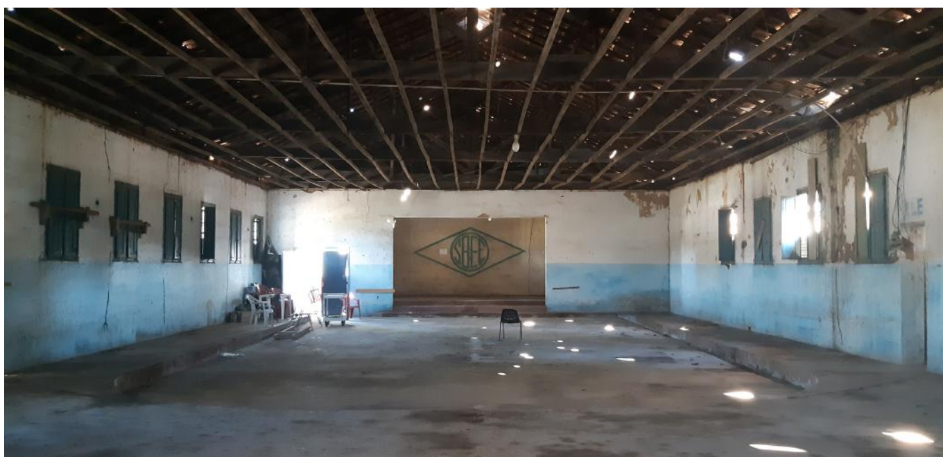
Interior da Casa de Farinha, que possui dois níveis. É possível ver a grande cobertura de madeira com um pilar de sustentação no meio do salão, inserido posteriormente por causa do recalque do terreno. Isso é confirmado nas rachaduras das paredes. Além disso, muitas manchas de infiltração, descascamento e telhas faltantes. (Fonte autoral)
