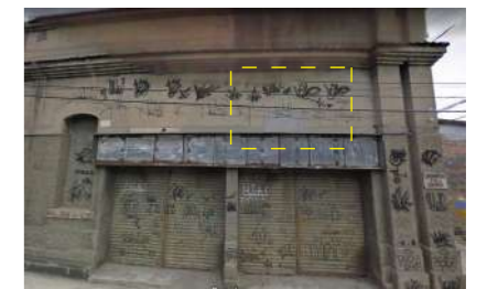
Alteração na fachada
