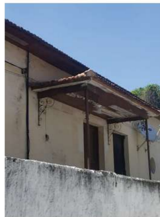
Problemas encontrados no forro da varanda.
