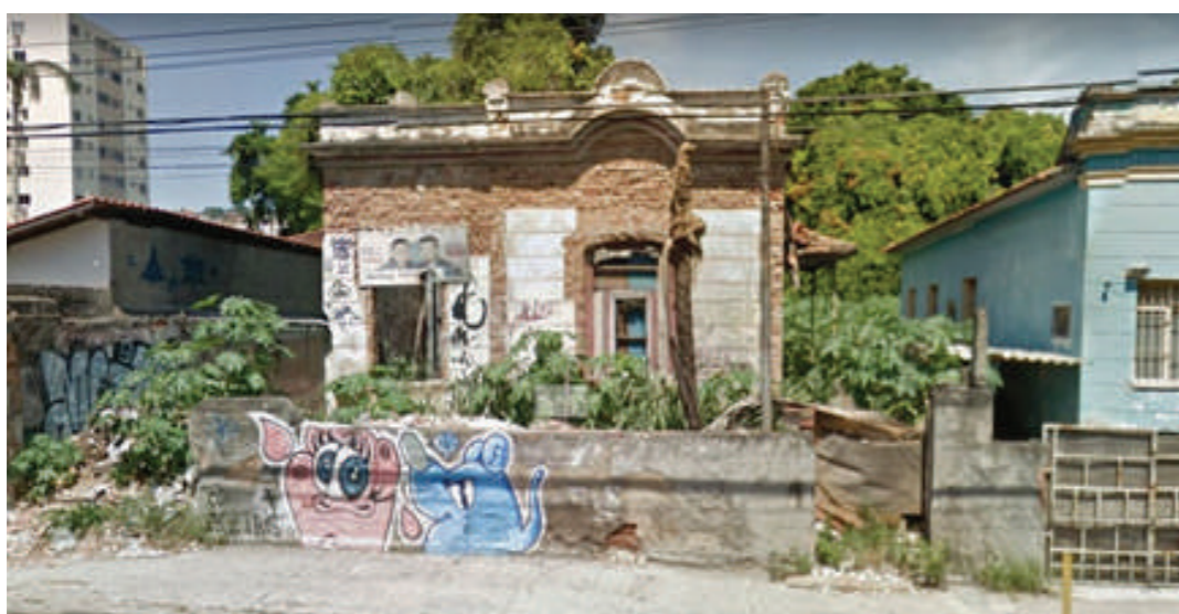
Casa da tipologia 1 em 2010, em estado de danificação avançado Fonte: Google Street View
