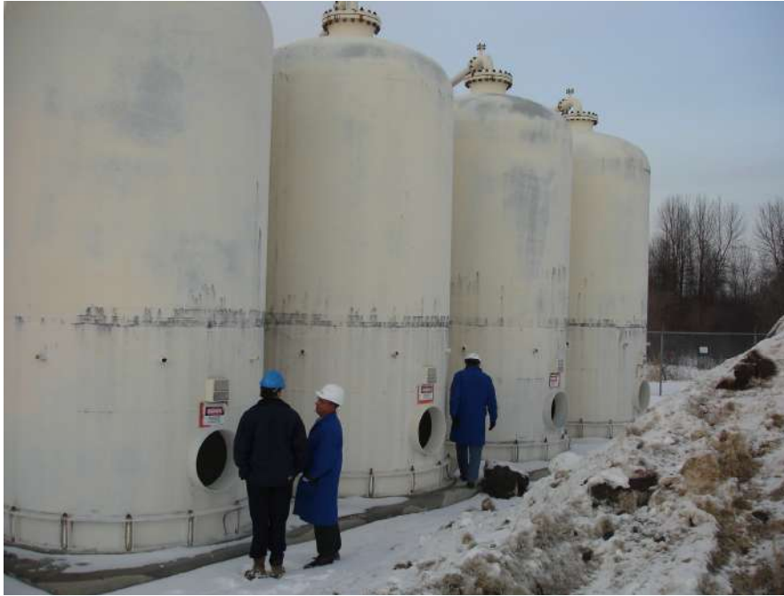
Fig. 4.5 – Foto de uma unidade de processo VPSA para CO 2 no Canadá. Fonte: Apresentações internas da White Martins
