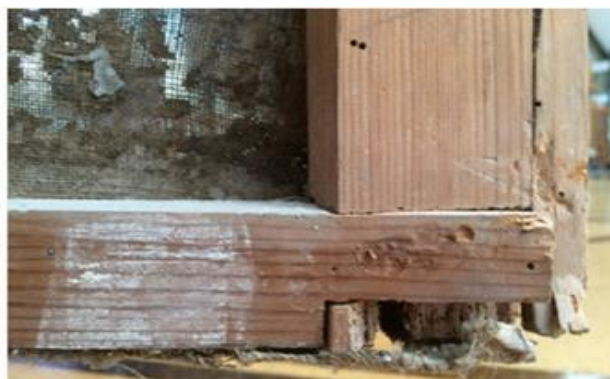
Figura 31: Detalhe de dano em quina de um chassi
