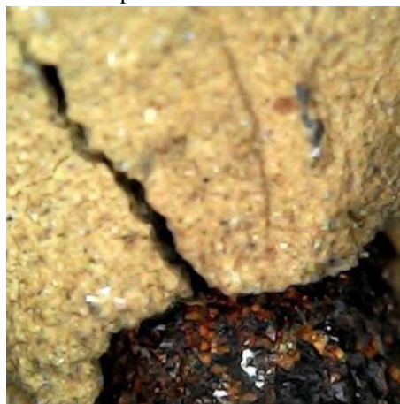
Figura 64 – Possível dano no suporte causado por corrosão - MDJ 11310.
