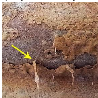
Figura 29 – Detalhe de delaminação e pulverulência do suporte cerâmico sobre eflorescência salina.
