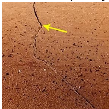
Figura 27 – Detalhe de rachadura com perdas de grânulos nas bordas.
