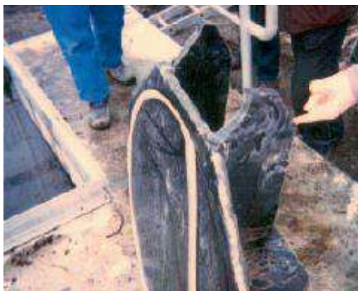
Figura 2.2: Válvula de retenção DN800 destruída devido à sobrepressão (LÜDECKE et al. , 2006)
