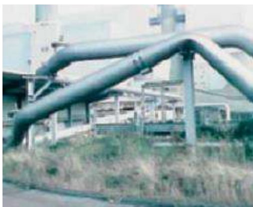
Figura 2.1: Tubulação com paredes de 12 mm de espessura destruída pelo golpe de aríete (LÜDECKE et al. , 2006)
