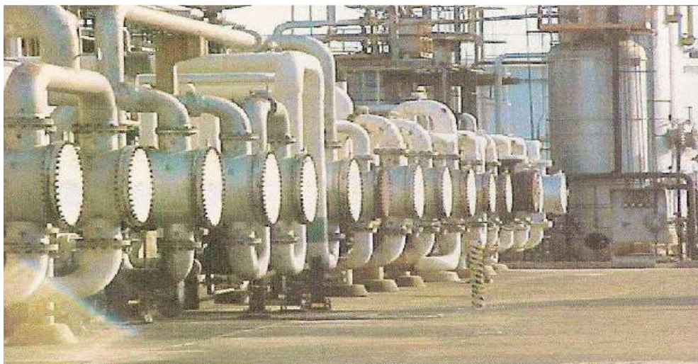
Figura 1-2 – Trocadores de calor em uma bateria de pré-aquecimento
