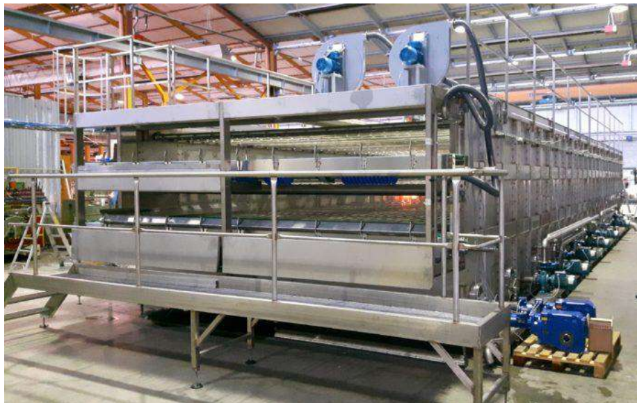
Figura 9 – Exemplo de túnel pasteurizador
