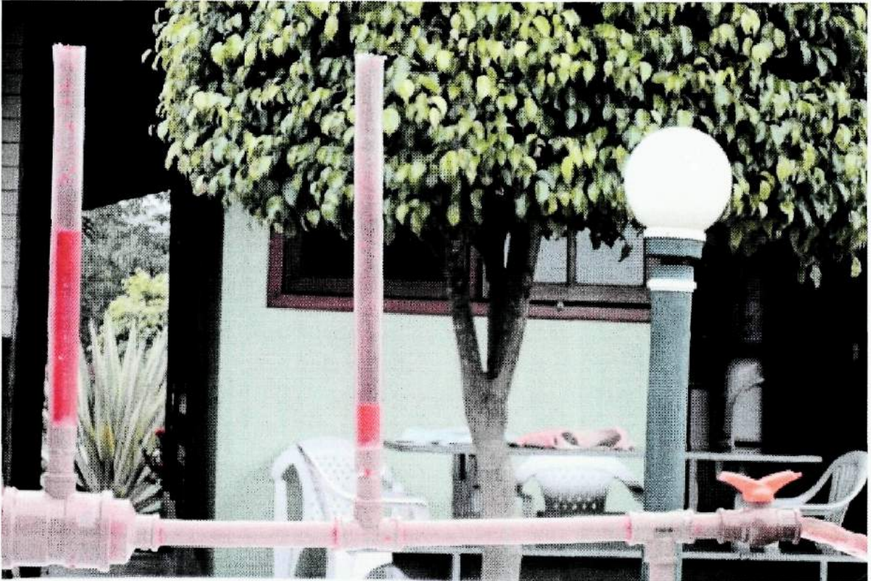
Figura 17- Desnível considerável entre os tubos, quando o registro é aberto.
