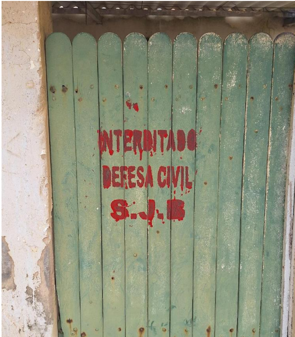
Figura 17: Porta de casa interdita no Pontal de Atafona pela Defesa Civil de São João da Barra.
