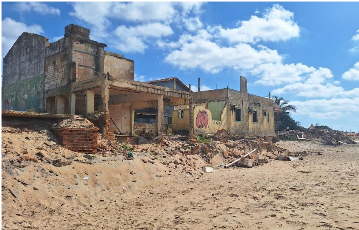
Figura 2: Residências em escombros em Atafona.
