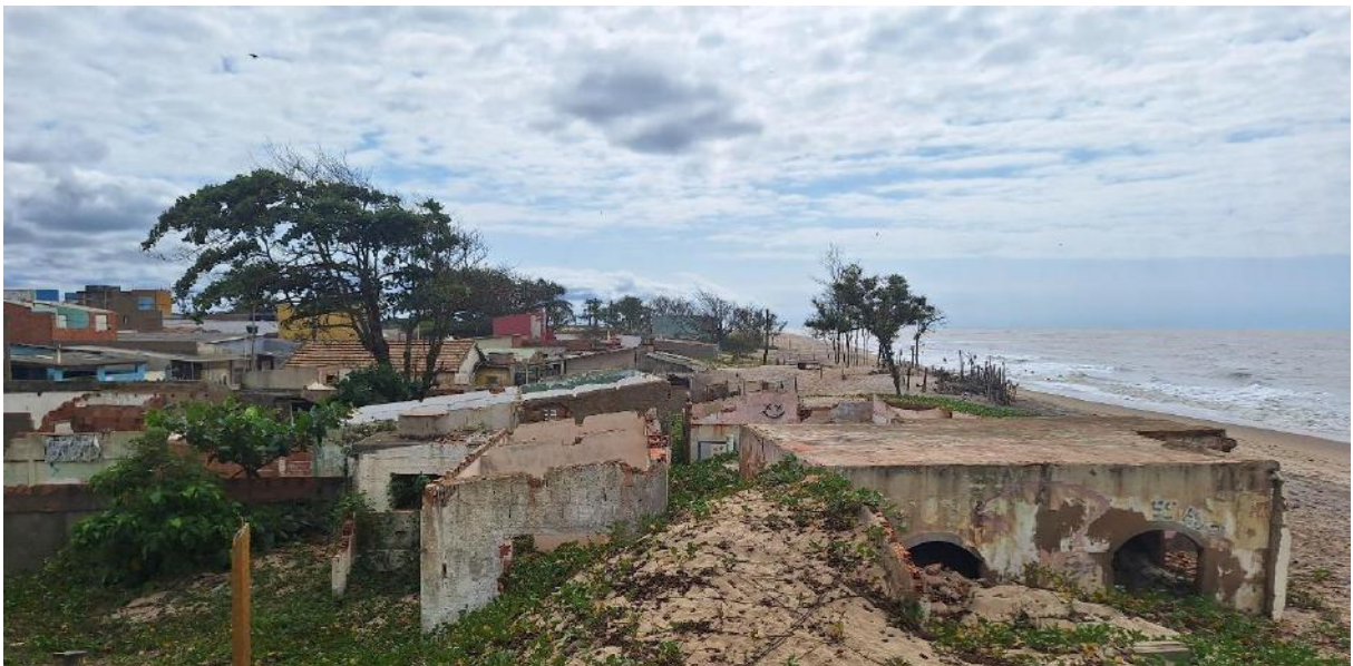
Figura 10: Casas em escombros no Pontal de Atafona.
