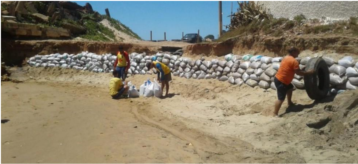
Figura 18: Sacos de areia colocados próximos a residências pela Defesa Civil para protegê-las de ressacas.
