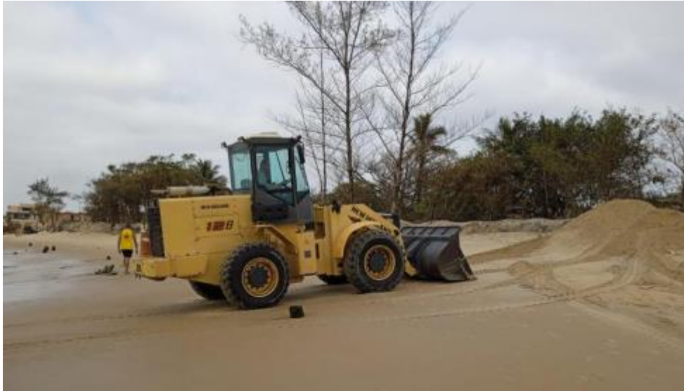
Figura 20: Reconstrução de diques para escoamento da maré alta no Pontal de Atafona.
