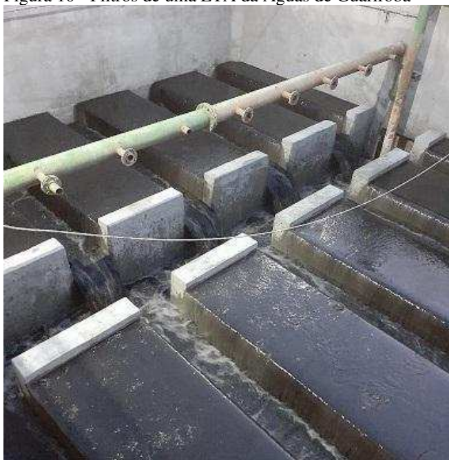
Figura 10 - Filtros de uma ETA da Águas de Guariroba
