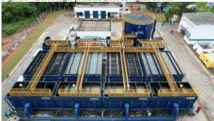
Figura 6 - ETA Magé: primeira ETA da Águas do Rio
