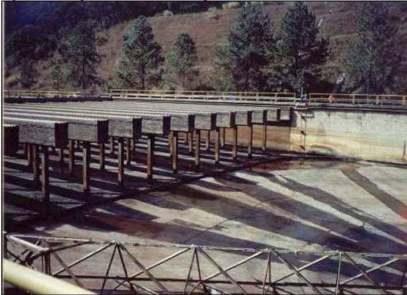
Figura 9 - Tanque decantador com raspador de lodo automático
