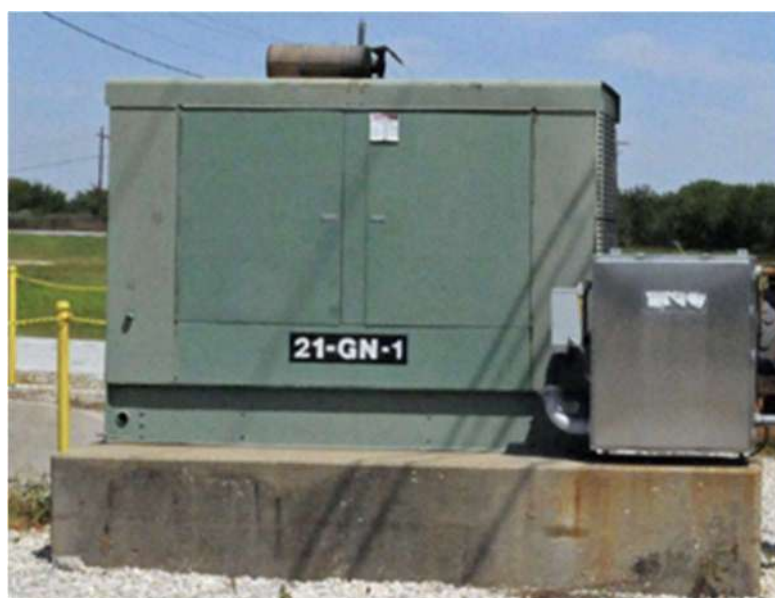
Figura 19: Geradores de emergência.
