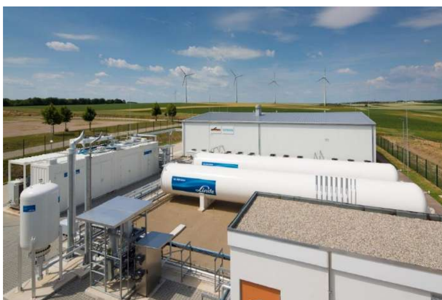
Figura 20: Planta de H2V da Salzgitter AG
