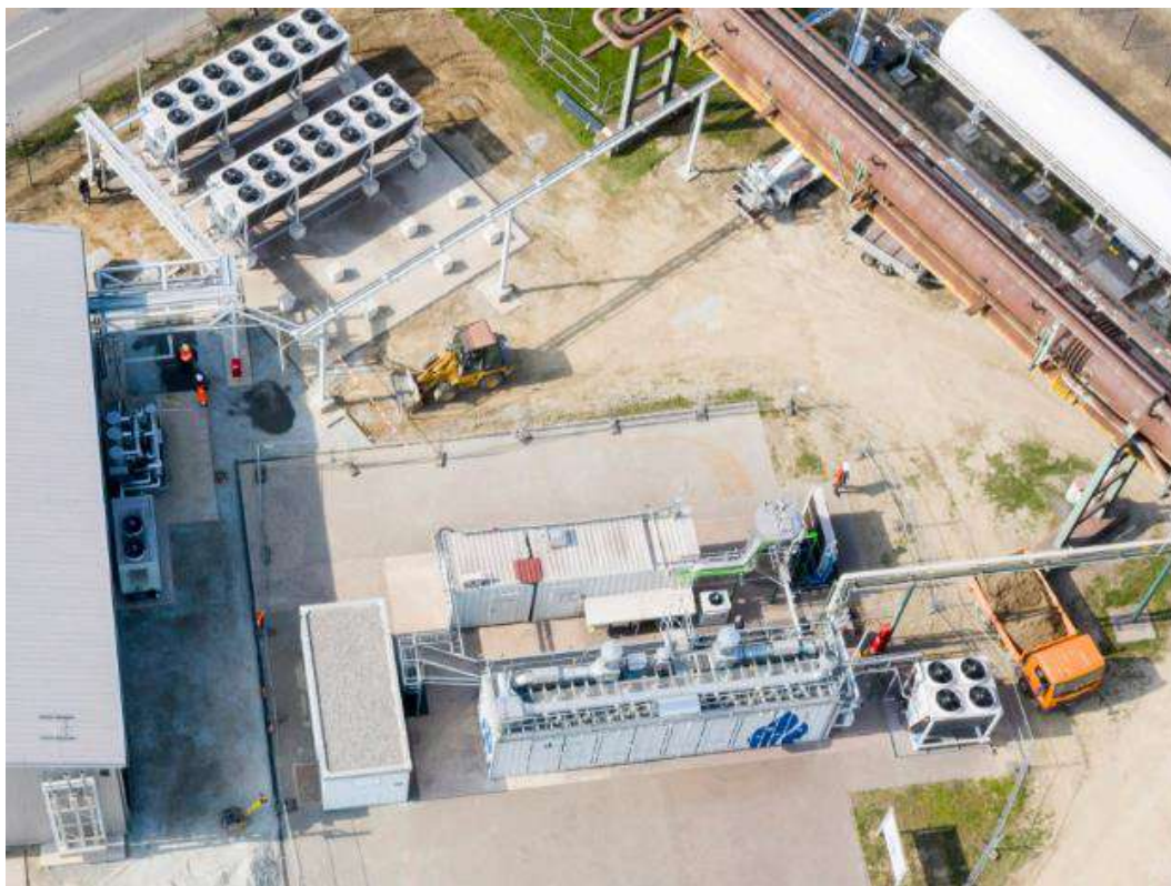
Figura 19: Planta de H2V da Salzgitter AG
