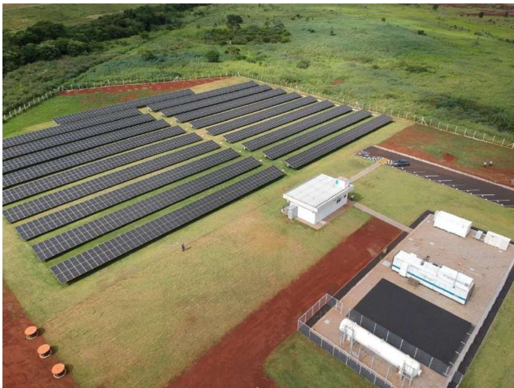
Figura 25: Planta de H2V da Eletrobras
