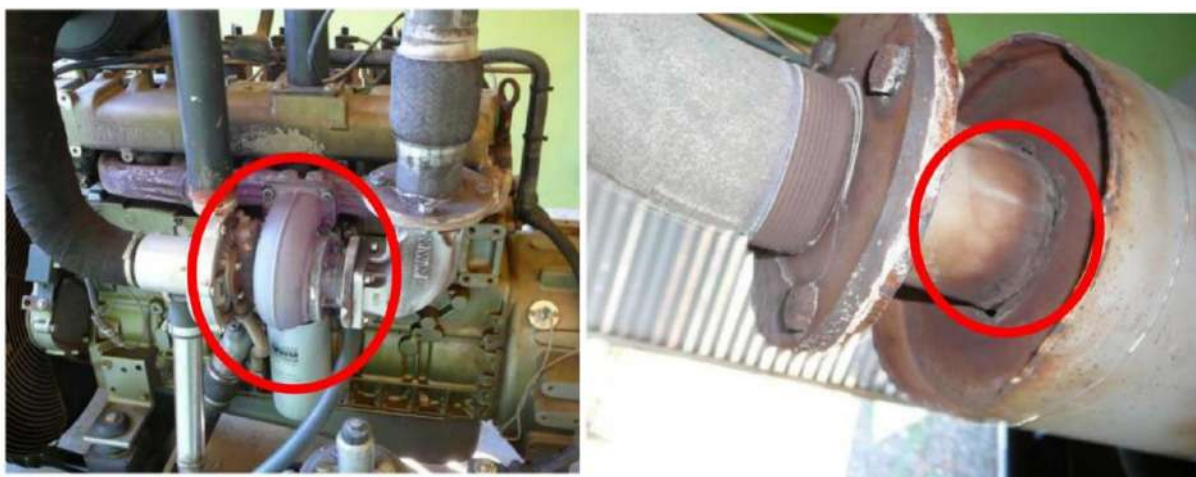
Figura 11 – Corrosão provocada por H 2 S em equipamentos de processo.
