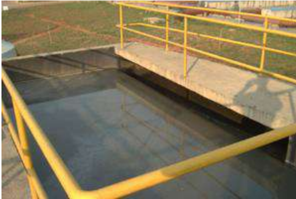
Figura 4 – Caixa de areia usada no tratamento de esgoto do município de Valinhos em São Paulo
