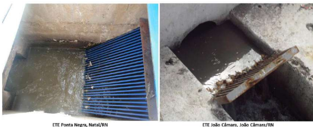
Figura 1 – Grades das ETEs de Ponta Negra e de João Câmara, no Rio Grande do Norte
