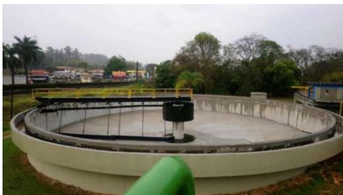
Figura 6 – Tanque de decantação com pás para a extração do lodo primário
