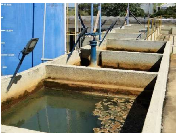
Figura 8 – Tanque de floculação
