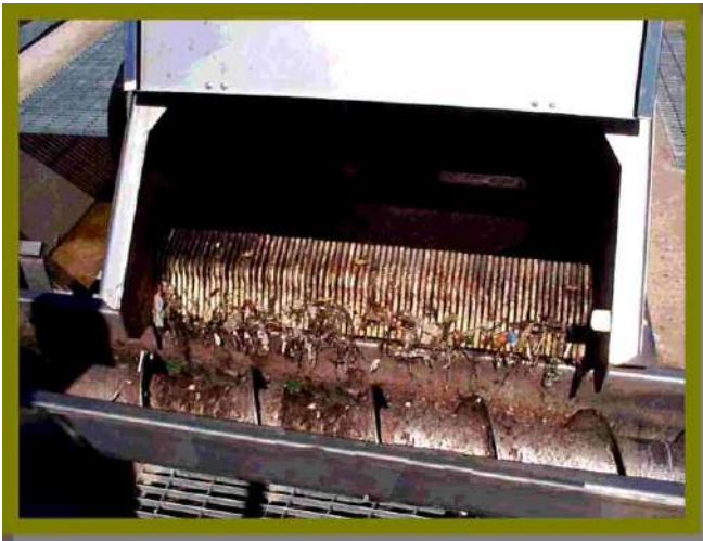
Figura 3 – Grade fina automática da estação de Caiçara em São Paulo
