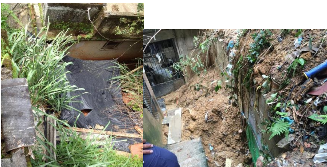
Figura 14 – Dois exemplos de eventos classificados como Solo. À esquerda: movimento de massa no morro do Borel, na Tijuca- a foto mostra o local coberto torando impossível a observação da superfície de ruptura. À direita: movimento de massa na comunidade da Rocinha - a foto não exhibe a superfície de ruptura. Fonte: Geo-Rio.
