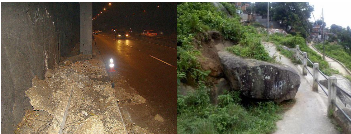
Figura 13 – À esquerda: Escorregamento translacional de rocha no Túnel Acústico, sentido Gávea, em 2013. À direita: Queda de bloco de rocha na comunidade Sumaré, em Rio Cumprido. Fonte: Geo-Rio.
