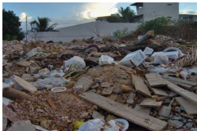
Figura 3. Resíduo de Construção Civil (Fonte: www.conder.ba.gov.br )
