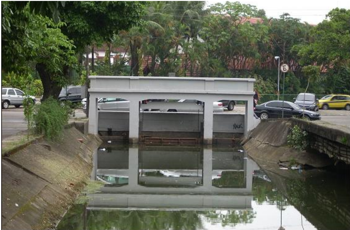
Figura 35: Vista da comporta que liga o rio dos Macacos com a Lagoa Rodrigo de Freitas (na ocasião fechada). Comunicação franca do rio dos Macacos com o canal do Jóquei, por baixo da rua, na margem direita (fonte: acervo pessoal do professor Marcelo G. Miguez).
