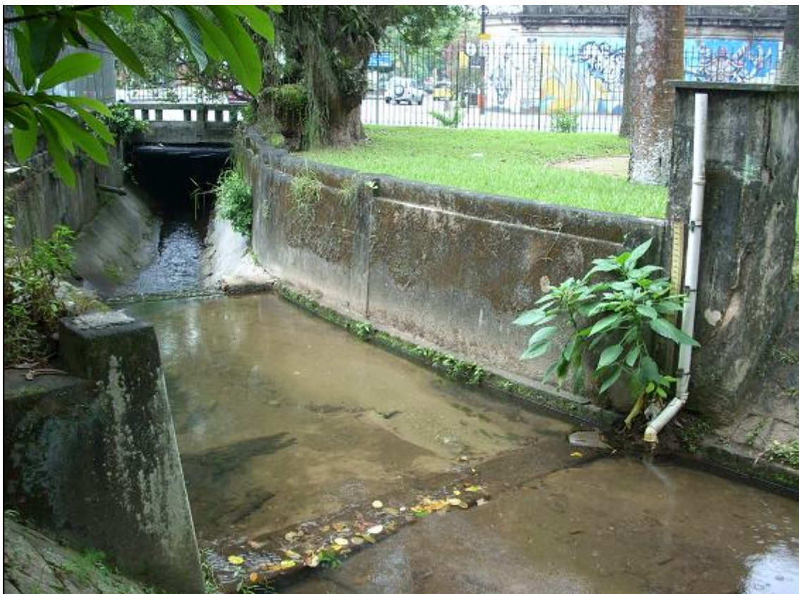
Figura 31: Vista da entrada em galeria do rio dos Macacos, dentro do Jardim Botânico, junto ao muro que define seu limite externo – percebe-se, nitidamente, o estrangulamento do escoamento, que sai de uma seção com largura superior a 6m para outra de cerca de 2,0 (fonte: acervo pessoal do professor Marcelo G. Miguez)
