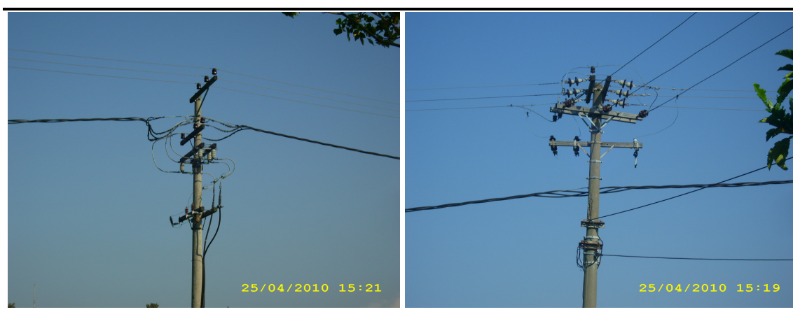
Figura 1: Derivações na rede aérea do sistema de distribuição
