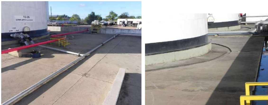
Figura 3-9: Sistema de drenagem interna das bacias de contenção dos tanques de armazenagem de inflamáveis (Fonte: Projeto Resíduos Portuários, 2014).
