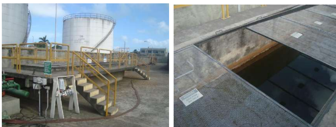
Figura 3-11: Sistema CSAO, para onde é direcionada a drenagem do entorno dos tanques de combustível (Fonte: Projeto Resíduos Portuários, 2014).
