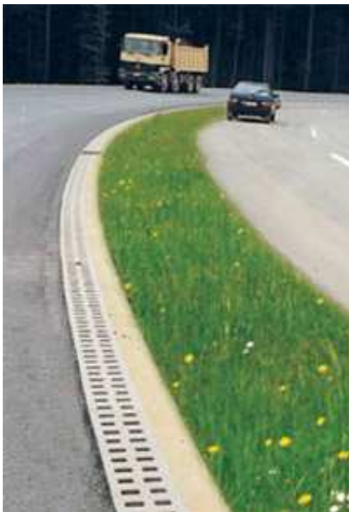
Figura 12 - Trincheira de infiltração funcionando como sarjeta (Fonte: http://www.acousa.com/road/highwaydrain.htm acessado em 29/04/2011)
