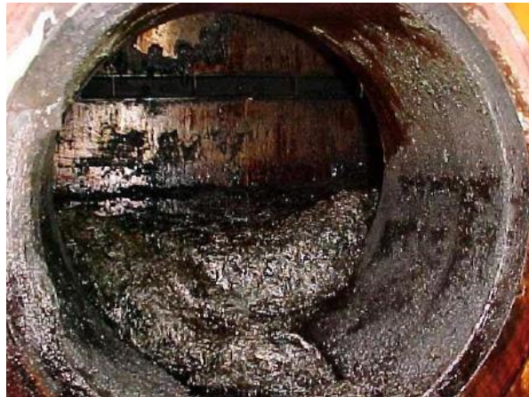
Figura 3 – Depósito de naftenatos de cálcio em compartimento de tratador eletrostático (Turner, 2005).
