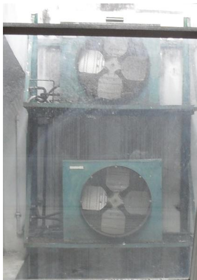
Figura 26 – Unidades condensadoras antigas, pouco eficientes e expostas ao tempo.
